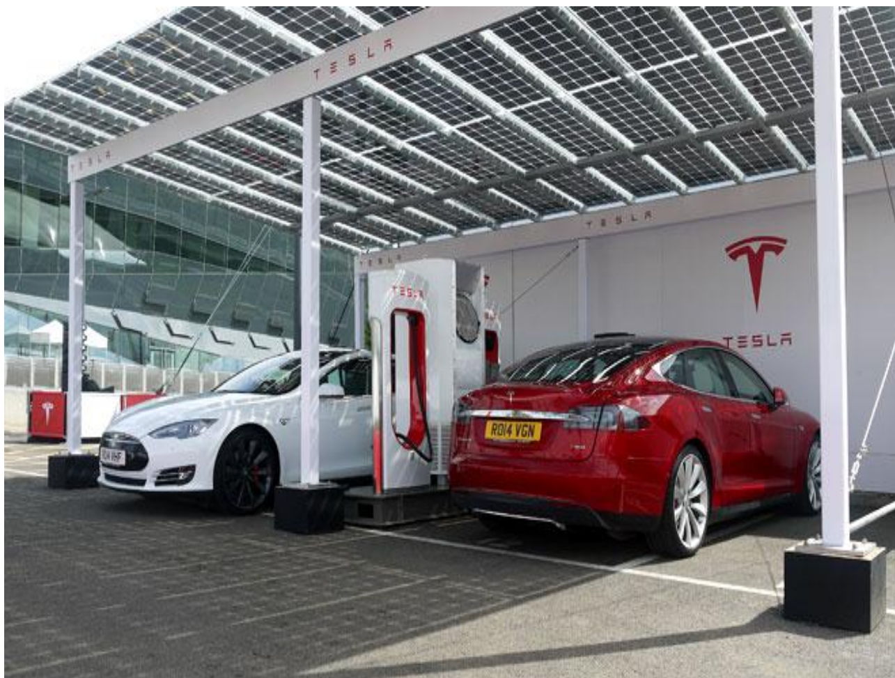
Рис. 1.28. Зарядна фотоелектрична станція електротранспорту Tesla (США).
